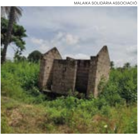
a totes les instal·lacions, sostre, portes i vàters, ja que només hi ha les parets de maó.
