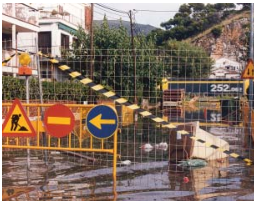
Danys a les obres del Baixador
