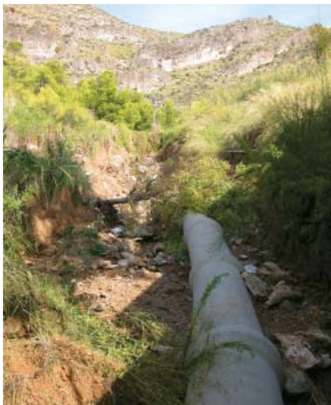
Desperfectes ocasionats per la pluja al col·lector de Poal
